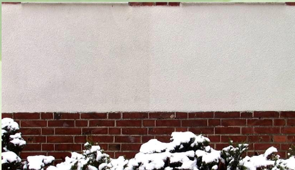
Fasad budynku po 4 latach od pomalowania
